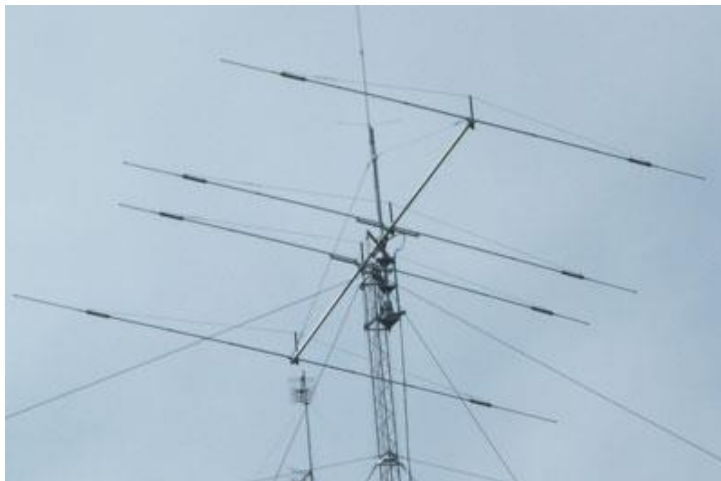
Figura 21 - Yagi encurtada e multibanda, para 10, 15 e 20m com 4 elementos. Podemos ver uma vertical no topo do mastro. As “bobinas” nos elementos tem múltiplas funções.
